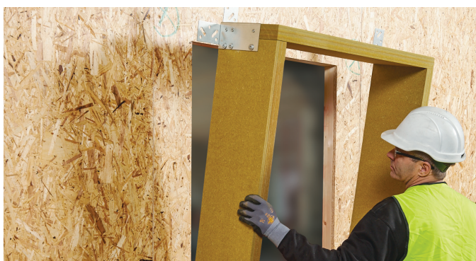
REDAir Link løftes på plads
