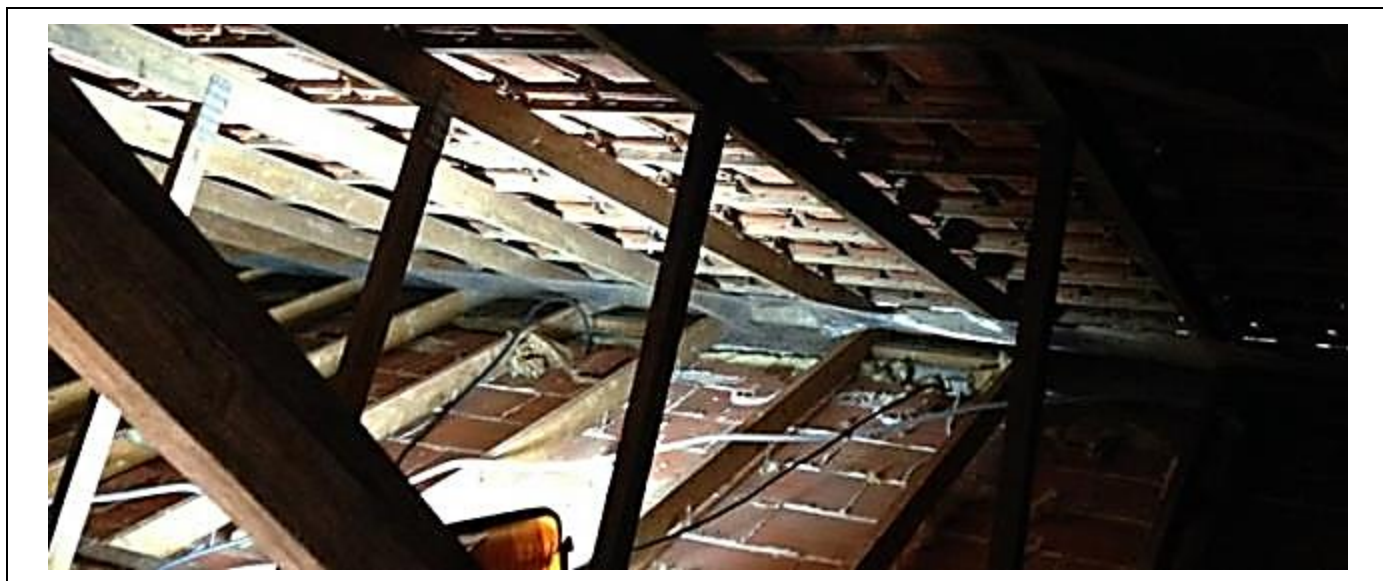
Figure 12 : Vue d'ensemble du grillage installé dans un comble à faible pente, entrée d'air par le galbe des tuiles
